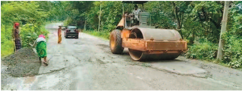
जगदलपुर। बस्तर जिले के केशलूर से सुक्मा जिले के तोंगपाल, छिंदगढ़, पाफेला तक सड़क में बड़े-बड़े गड्डे हैं, लोगों को सुविधा के लिए लोक निर्माण विभाग राष्ट्रीय राजमार्ग की ओर से गड्डों को पाटा जा रहा है।
